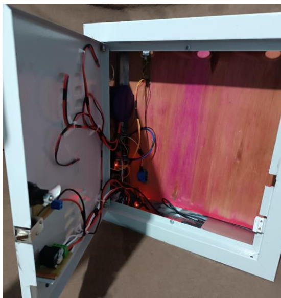
FIGURA 2. Disposição física do sistema de segurança no cofre.
